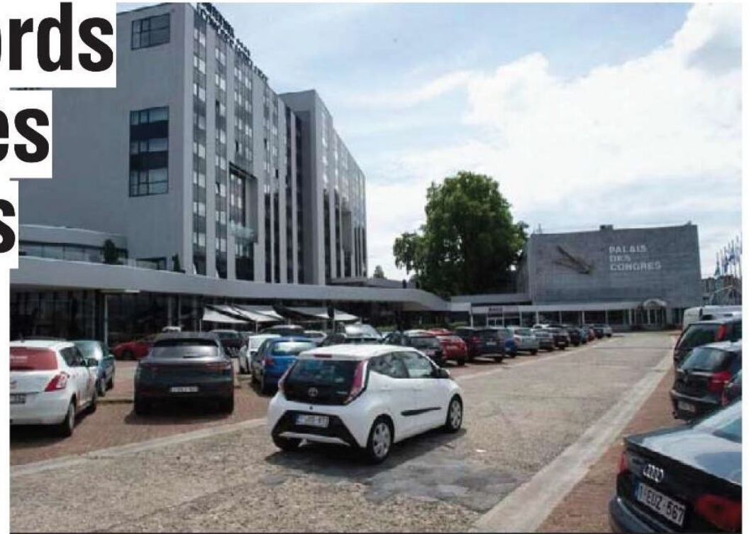
Le parking de l'hôtel Van der Valk et du Palais des Congrès est dans un état lamentable. © Thomas Van Ass
